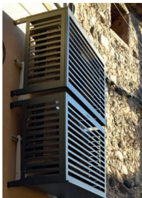
Climatiseur en saillie interdit sur les rues principales, cache clim nécessaire sur les rues secondaires
