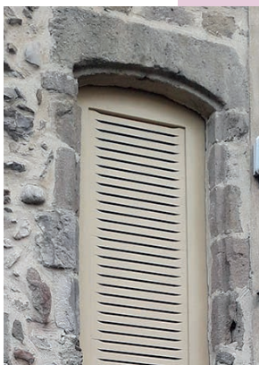
Climatiseur intégré dans une niche masquée par une grille (ventelle)
